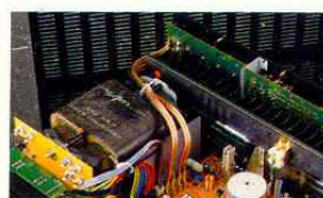
Der Ausgangsleistung entsprechende, großdimensionierte Leitungsführung.
